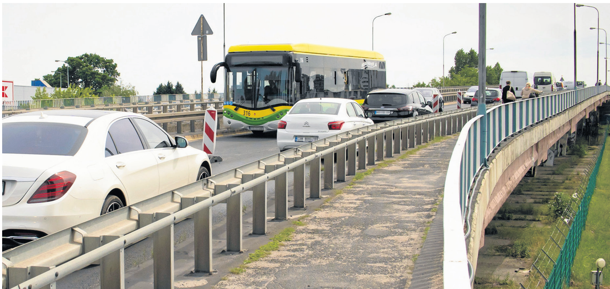
Konstrukcja nośna wiaduktu jest uszkodzona. Ze względów bezpieczeństwa od poniedziałku aż do odwołania nie będą mogły tędy jeździć ciężarówki i autobusy.
