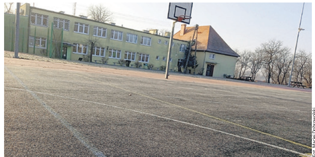
Nawierzchnia szkolnego boiska jest już bardzo starta, tworzą się pęknięcia
