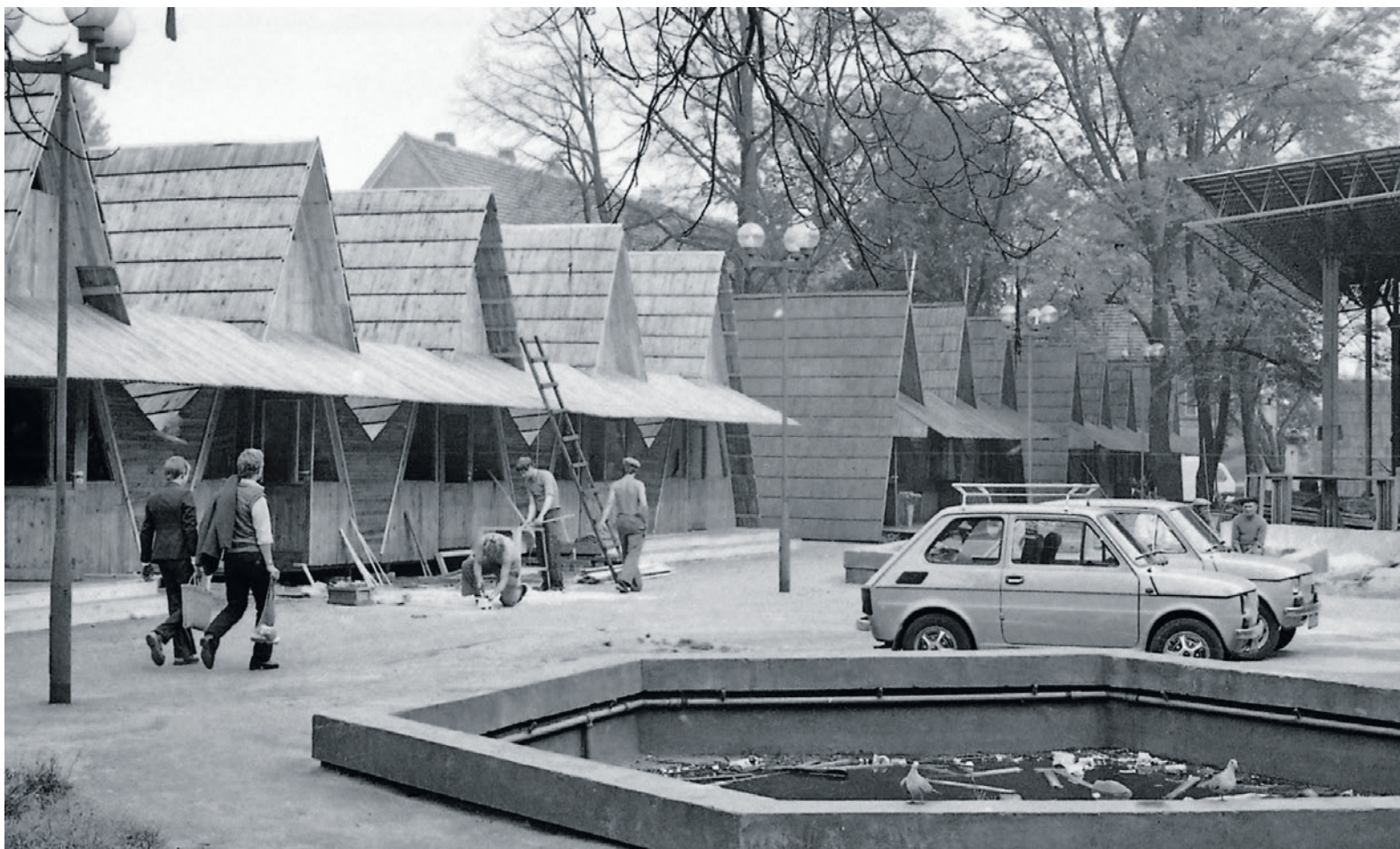
Wrzesień 1980 r. Trwa budowa ostatnich domków góralskich. Po prawej widać fragment wielkiej wiaty, pod którą ustawiono m.in. lokal gastronomiczny. Na pierwszym planie fontanna, która zamieniła się w śmietnik.
