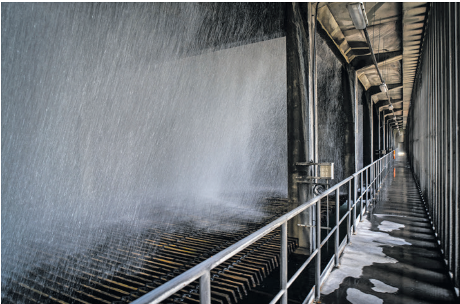
Wnętrze chłodni - tu setki ton wody spadają, tworząc wielką kaskadę. Dzięki temu woda traci około 10 stopni Celsjusza ciepła i może być użyta ponownie do chłodzenia urządzeń.
