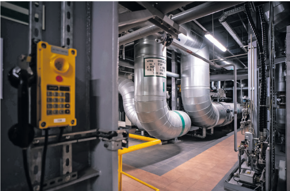
W newralgicznych miejscach znajdują się telefony alarmowe. To zabezpieczenie na wypadek awarii i blokady przeciążonych sieci komórkowych.
