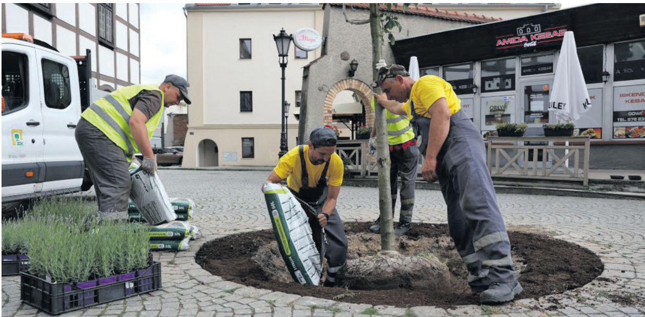
Drzewa są tak dobrane wielkością, żeby nie uszkodziły elewacji ani instalacji FOT. PIOTR JĘDZURA
