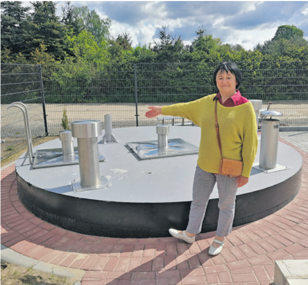
Sołtyska Dorota Bojar pokazuje nową pompownię ścieków przy ul. Topolowej
