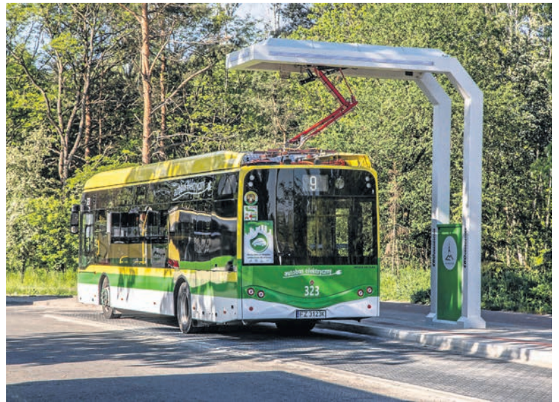
Na potrzeby nowego systemu przebudowano 11 pętli autobusowych ze stacjami ładowania
