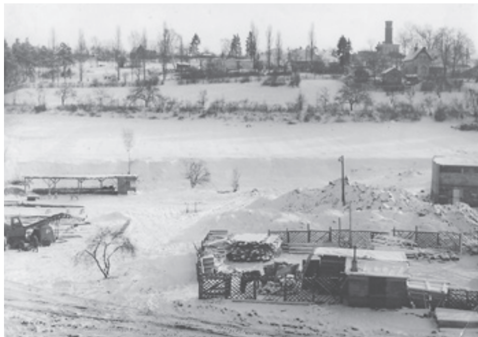
Kilka lat wcześniej. Ul. Podgórna - początek robót na os. Wazów III Fot. Bronisław Bugiel
