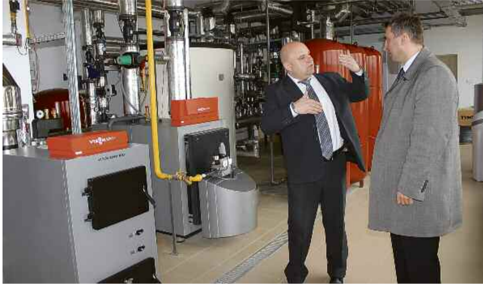
- Ciekawostką jest chłodziarka absorpcyjna, która produkuje chłód z ciepła - mówi dr Piotr Ziębicki, kierownik Laboratorium Wytwarzania Energii Elektrycznej
