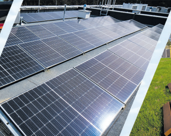
Energię dostarcza fotowoltaika na dachu
