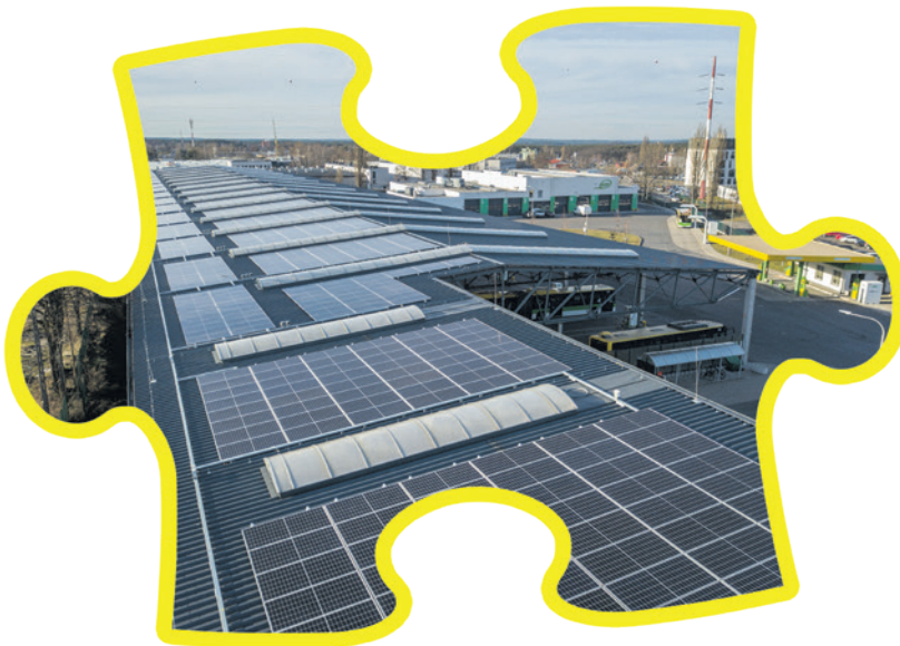
Na dachach zajezdni przy ul. Chemicznej zamontowano farmę fotowoltaiczną o mocy nominalnej 509,6 MWh.
