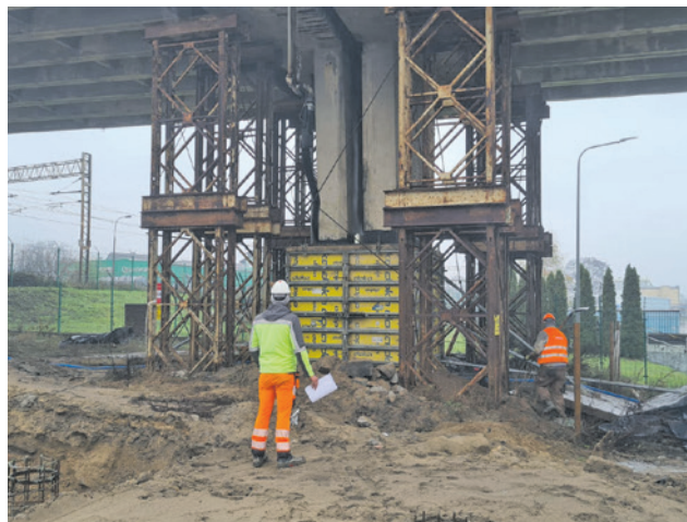
Podczas betonowania pobrano próbki do badań, po siedmiu dniach zostanie sprawdzona wytrzymałość betonu
