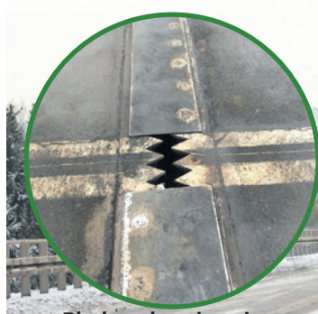
Blachy zabezpieczające szczelinę dylatacyjną
