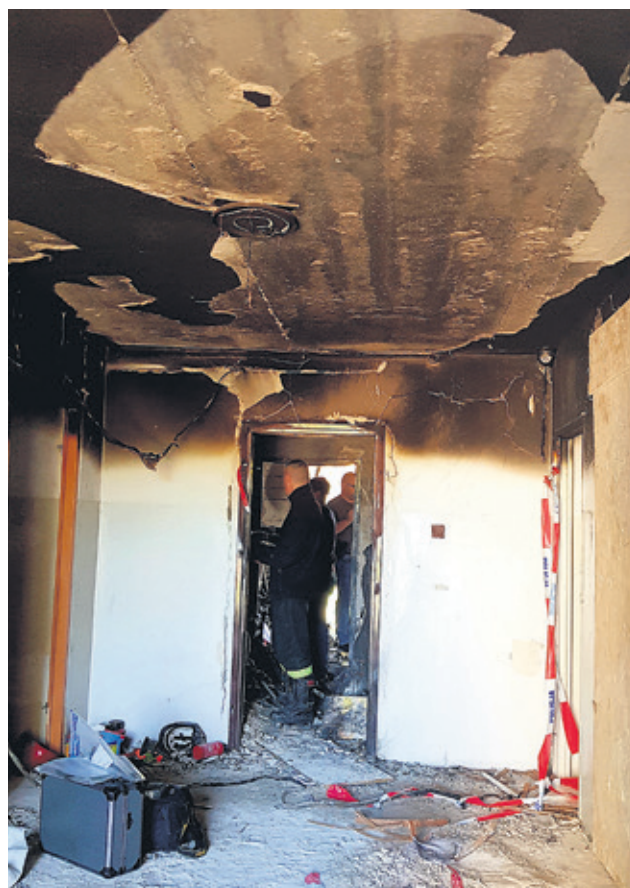
Tak wygląda klatka schodowa przed wejściem do spalonego mieszkania
