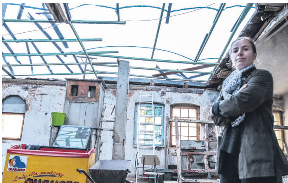
- Choć spaliła się część dachu, do naprawy jest cały, 800 mkw. - martwi się Kamila Chrostowicz-Nowak, właścicielka Piekarni Cichej Kobiety Fot. Piotr Jędzura
