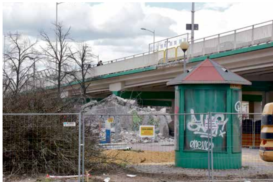
Nie ma też schodów na wiadukt. W przyszłości będzie tutaj kładka z windą.
