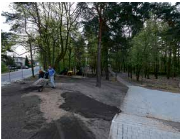
Kiedyś stał tu transformator - teraz będzie tu główne wejście do parku dla spacerowiczów i rowerzystów Fot. Krzysztof Grabowski
