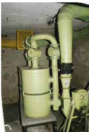
Filtr powietrza zamontowany w schronie pod widownią Fot. Tomasz Czyżniewski
