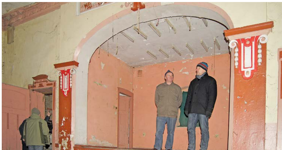
Najbardziej zniszczony jest dach nad sceną
