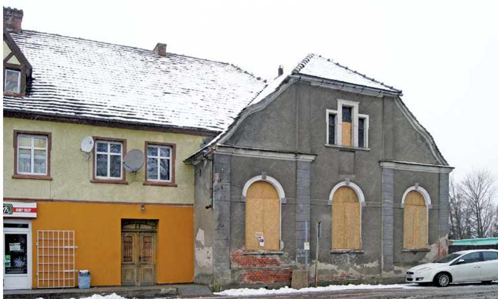
Świetlica straszy przechodniów zabitymi oknami
