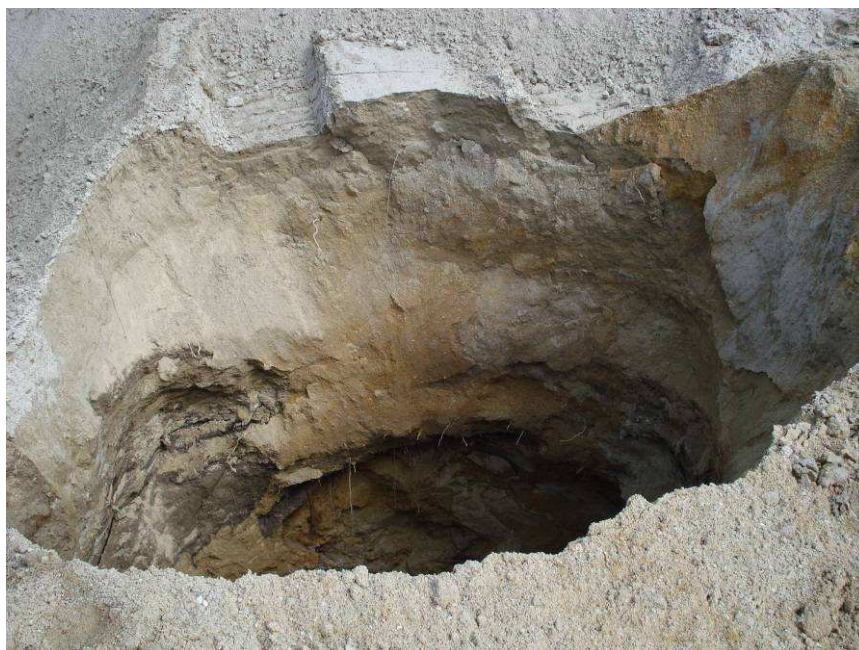
Fot. 5.5. Zapadlisko w miejscu szybu na obwodnicy Łęknicy, 2011
