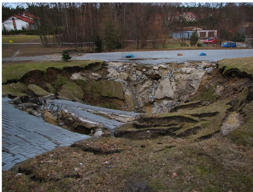
Fot. 5.7. Zapadlisko na terenie przysiółka Rybno. Stan na marzec 2012.
